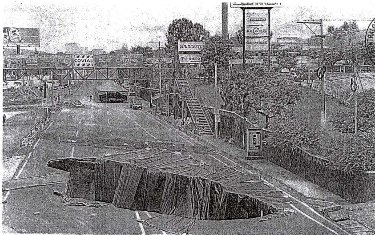
La ruta al Pacífico colapsó la semana pasada luego de un hundimiento en el kilómetro 15.
